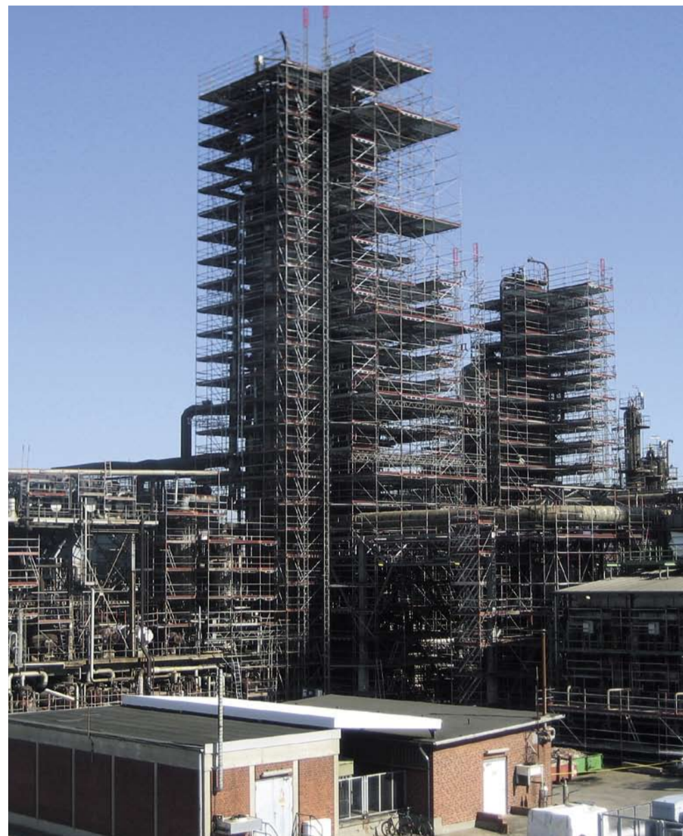
Przy drugim dużym przestoju w północnej części rafinerii konieczne było ustawienie rusztowań przy czterech kolumnach. Objętość rusztowania na jedną tylko kolumnę wynosiła 16.000 m 3 .
