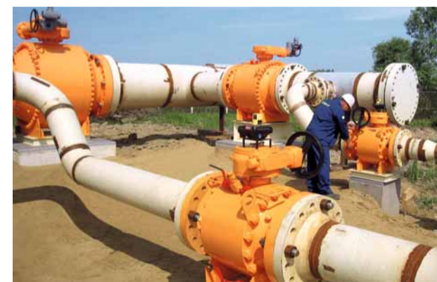
Rurociągi i armatury nowych kompresorów mają imponujące rozmiary.
