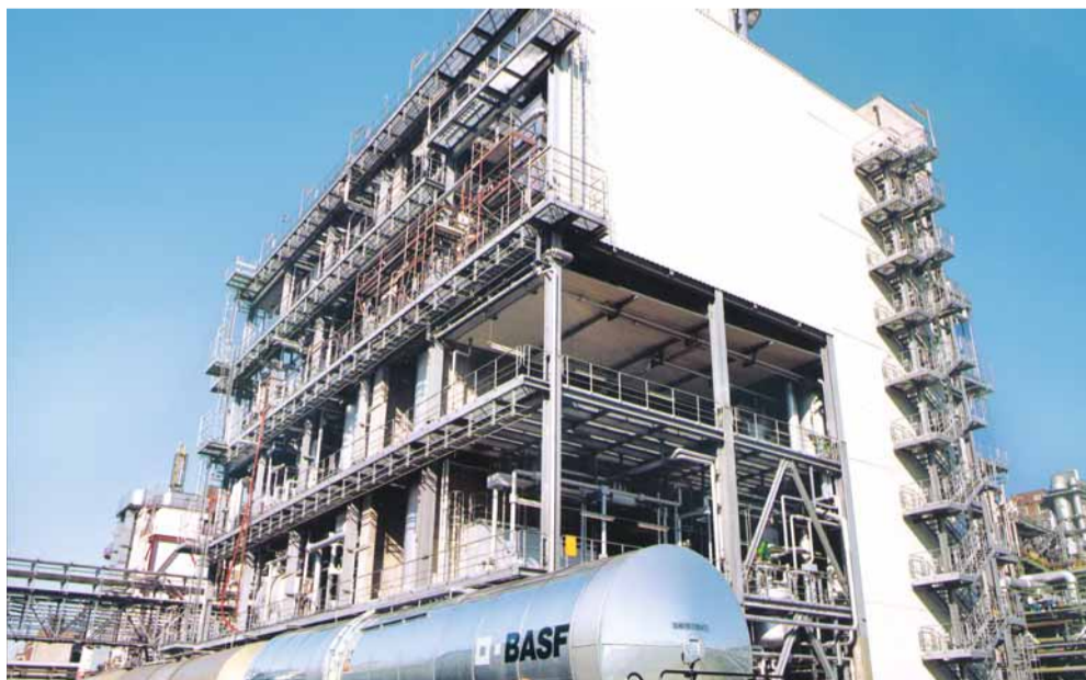
Projekt rurociągów dla instalacji cytralu w zakładzie BASF w Ludwigshafen stawił przed firmą Peters Engineering bardzo wysokie wymagania.
