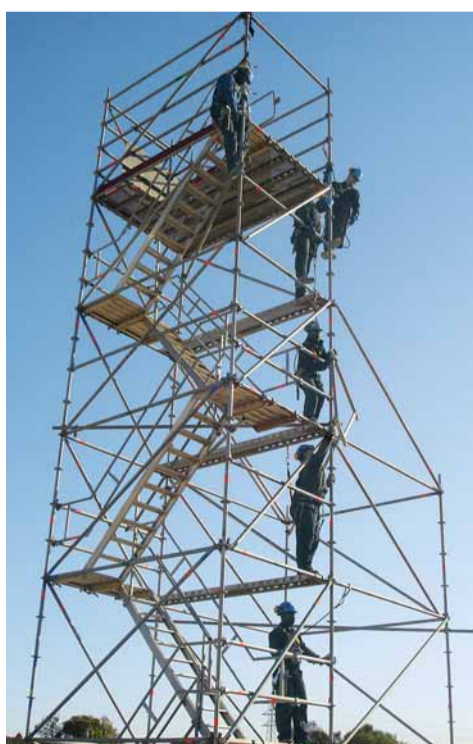
Bezpieczna praca na rusztowaniach traktowana jest w BIS priorytetowo. Klienci nagradzają takie podejście.
