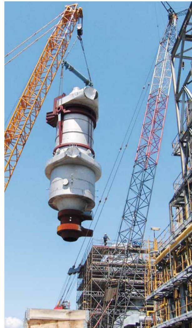
Ważący 330 ton reaktor styrenu w fabryce BASF w Antwerpii wymagał w użyciu specjalnego dźwigu.
