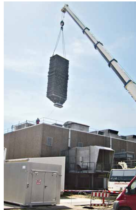
Der Aushub des rund 35 Tonnen schweren Rekuperators ging genauso reibungslos vonstatten wie der Einbau des elf Meter langen neuen Abgaskamins.
