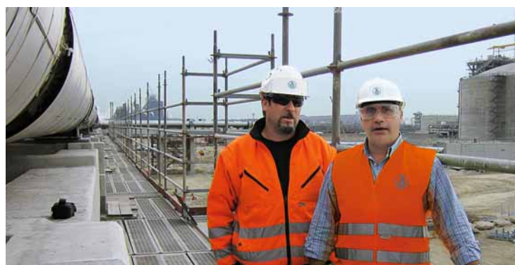
Zu einem der größten LNG-Projekte in Europa zählt die Anlage in Fos Cavaou auf einem Gelände von 75 Hektar.
