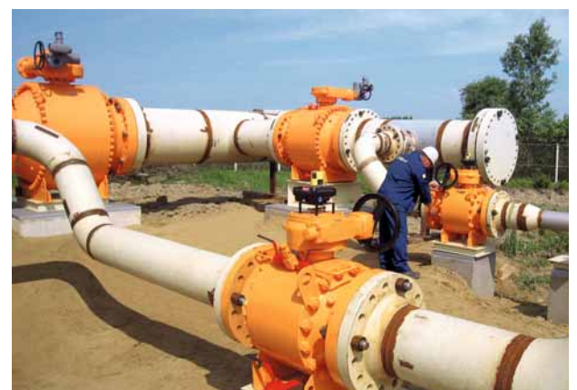
Die Rohrleitungen und Armaturen der neuen Kompressoren haben beeindruckende Ausmaße.
