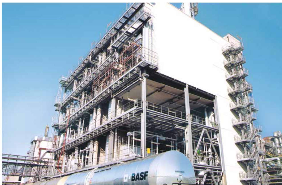
Die Rohrleitungsplanung der Citral-Anlage bei BASF am Standort Ludwigshafen war für Peters Engineering höchst anspruchsvoll.
