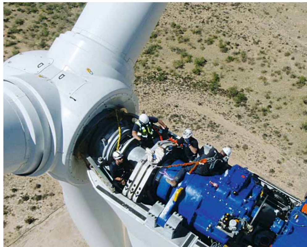
Über eine Leiter gelangen die Spezialisten von BIS Salamis Inc. ins Innere der Turbinen. Große Hitze erschwert die Arbeit vor allem in den Sommermonaten.
